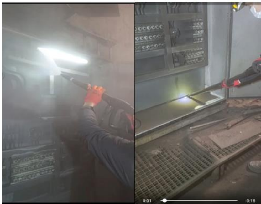
Slika 6: Pranje i usisavanje unutrašnjosti ormara sopstvene potrošnje 0,4 kV
